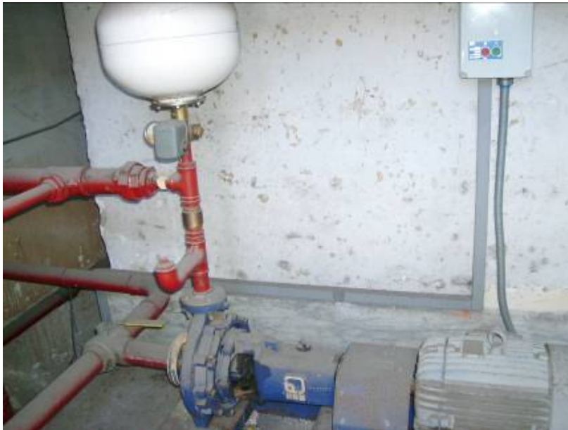
Equipo de presurización para combate de incendio
